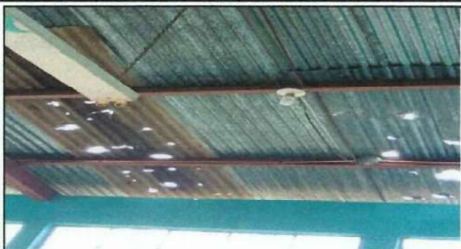
Laminas en mal estado en su mayoría oxidadas y con agujeros
