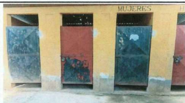
Puertas de baño en mal estado y bisagras en las puertas en mal estado
