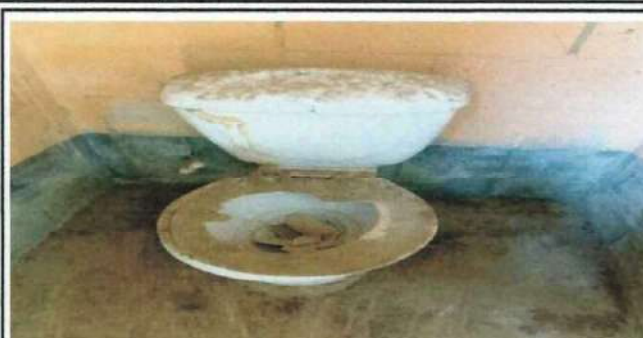
Baños en mal estado por deterioro y no están en función
