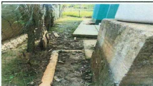
Tubo de canal de agua en mal estado, quebrado y dañado por las inclemencias del tiempo
